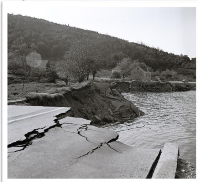
Crnogorski zemljotres 1979.- tonjenje tla i posljedici likvifakcije u Bokotorskom zalivu. Montenegro 1979 earthquake - shore sinking in Boka Kotorska Bay.
